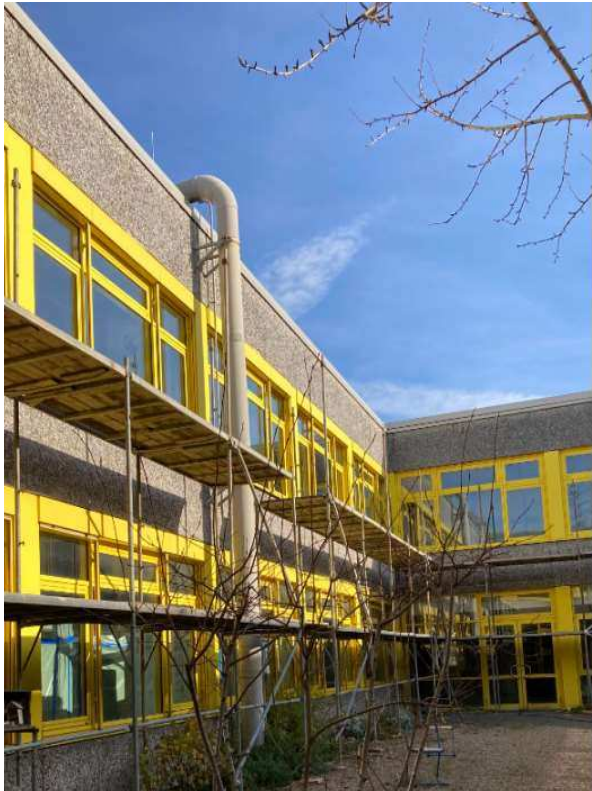
Abb. 1: RS Broich – Zustand der Fassade vor der Sanierung
